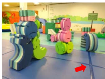
破れた箇所は、ビニールテープで 応急処置していました。
